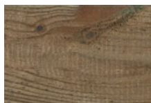
Raue Stellen auf der Holzoberfläche
