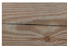
Spannungsrisse durch die Holz Trocknung
